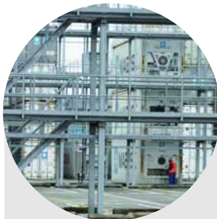
Wachsende Kapazitäten: Im Zuge der Terminalerweiterung werden auch zusätzliche Plätze für Kühlcontainer geschaffen.
