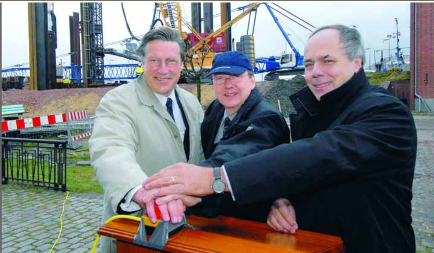
Erster Rammschlag: bremenports -Chef Jürgen Holtermann, Bremens Hafensenator Ralf Nagel und der Hochtief-Vorstandsvorsitzende Henner Mahlstedt eröffneten im November 2007 die Bauarbeiten zur neuen Schleuse.
