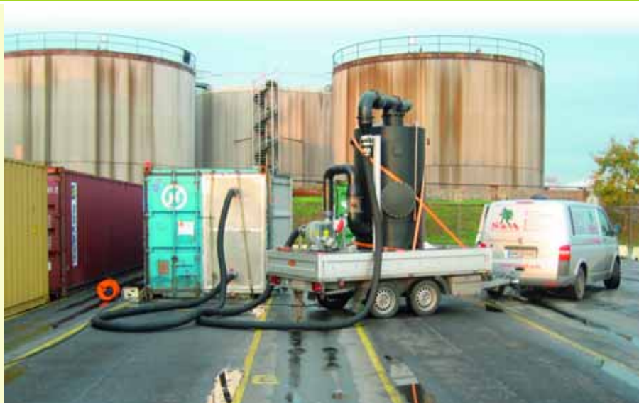
FILTERANLAGE IN BETRIEB: Im Hamburger Hafen sind Filteranlagen bei Containerbegasungen mit Methylbromid und Phosphorwasserstoff vorgeschrieben.
